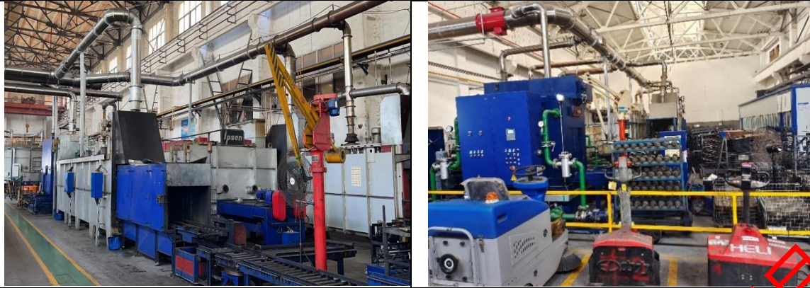
推 2 热处理连续炉（设备室内布置）
