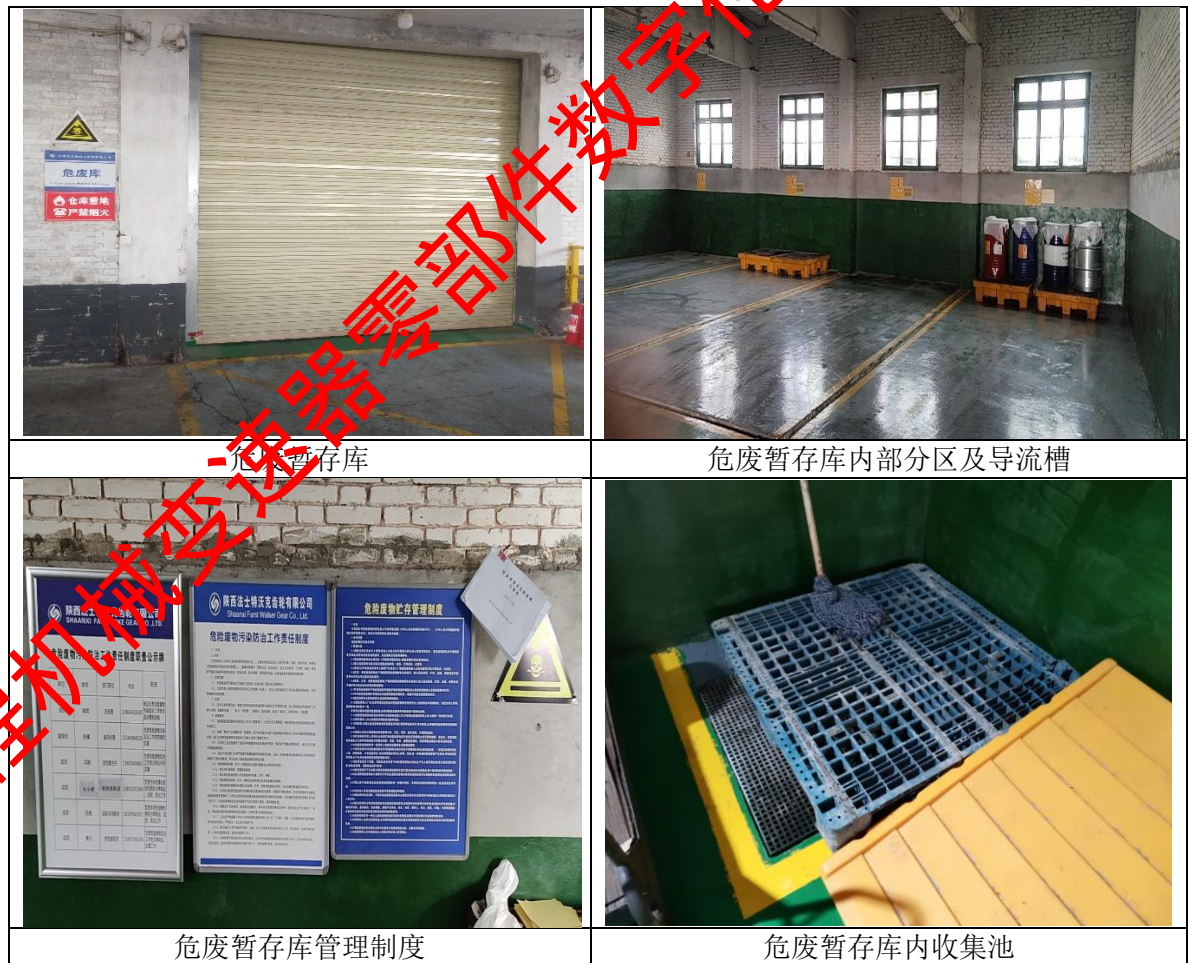
图 3-5 项目固体废物暂存设施现场照片
